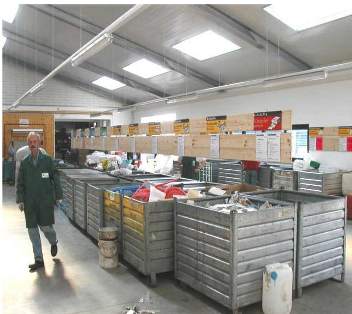
Εικόνα 32: Εσωτερική άποψη κτιριακών εγκαταστάσεων ΓΡ ΑΣΑ και ογκωδών
